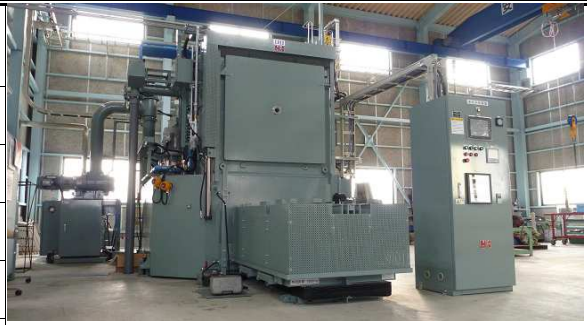
真空浸炭設備
